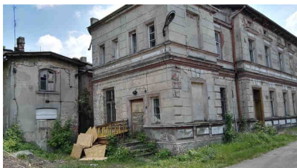
Fotografia: Oficyna pałacowa w stanie zdewastowanym
